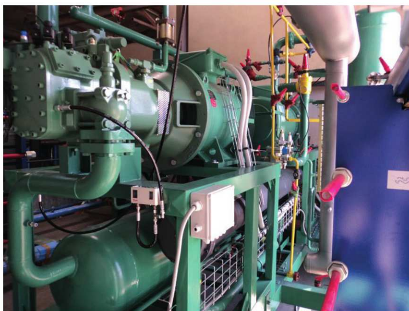
Chez SORELAIT, le nouveau système de type «plug'n'play» a pu être raccordé rapidement à l'ensemble du circuit / At SORELAIT, the new «plug'n'play» system has been quickly connected to the whole circuit (doc. ALFA LAVAL).
