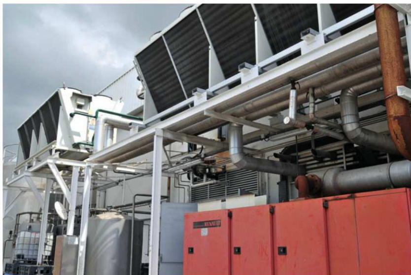
Le nouveau système de réfrigération installé chez SORELAIT est efficace et économe en énergie / The new cooling system installed at SORELAIT is efficient and saves energy (doc. ALFA LAVAL).
